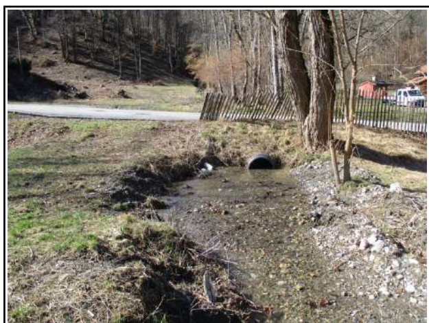
Figure V.4: Buse sous la route partiellement obstruée
