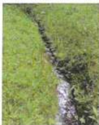
Système de drainage le long de la route.
