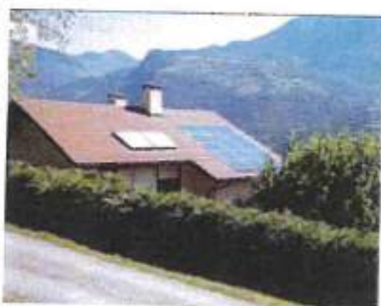
Équipement photovoltaïque chez un particulier de Saint-Oyen
